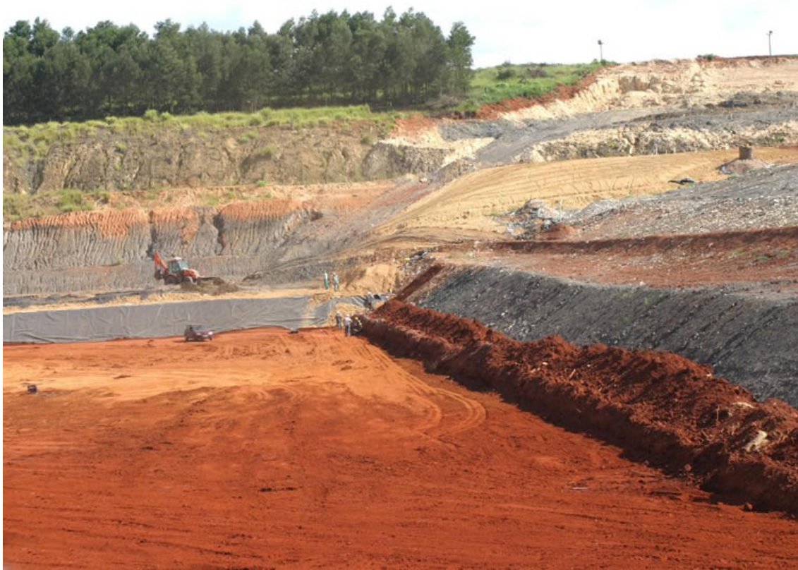
Figura 26. Aterro Sanitário – SIL Soluções Ambientais – Minas do Leão/RS
